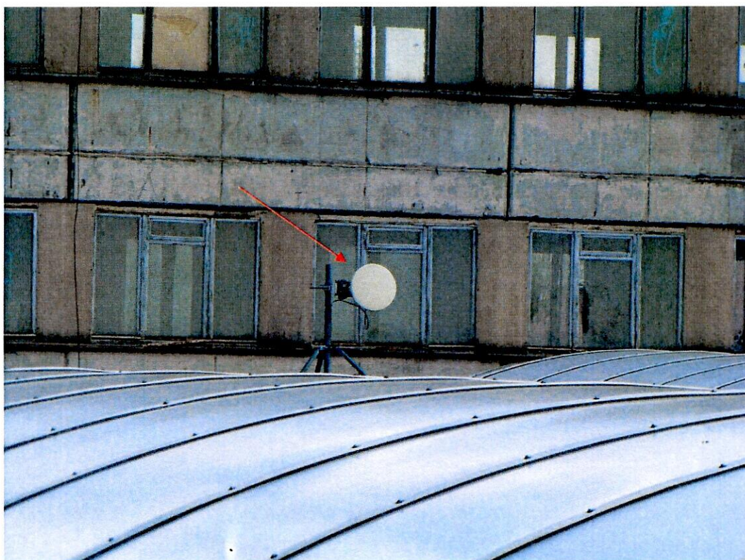
Widok instalacji radiokomunikacyjnej Stacja Netia WYSWB033 - WYSWM00005 Wyszaków, ul. Stolarska 1.
